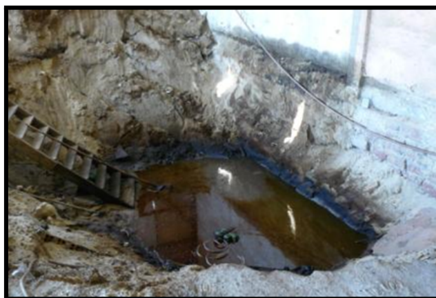
Foto 26 - Cava de drenagem com óleo infiltrado no solo
