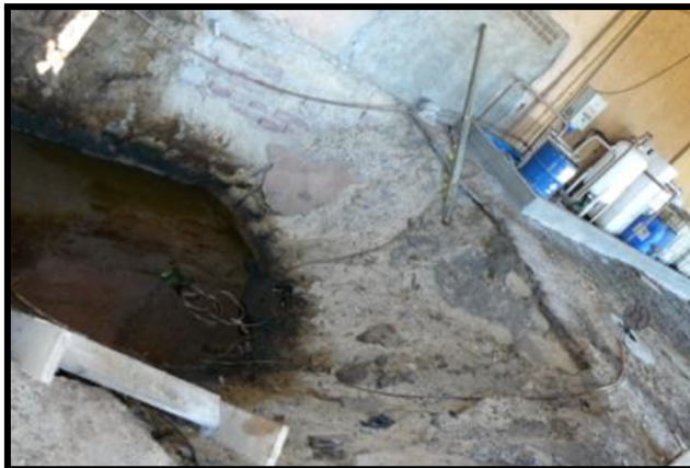
Foto 27 - Sistema de bombeamento do óleo
