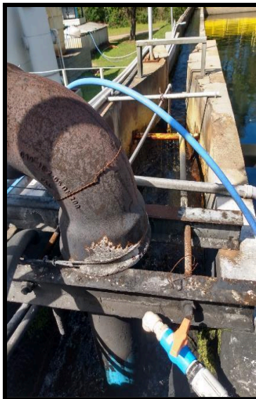
Foto 32.(a) - Tubulação de ferro fundido DN 200 da entrada da a ET
