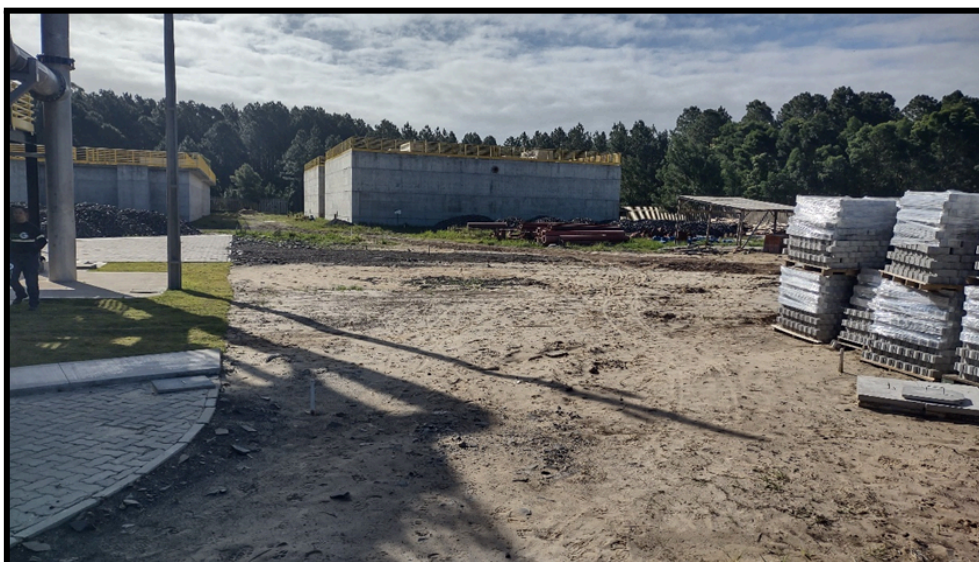
Foto 36.(c) - Vista do UASB/filtro aerado/decantadores
