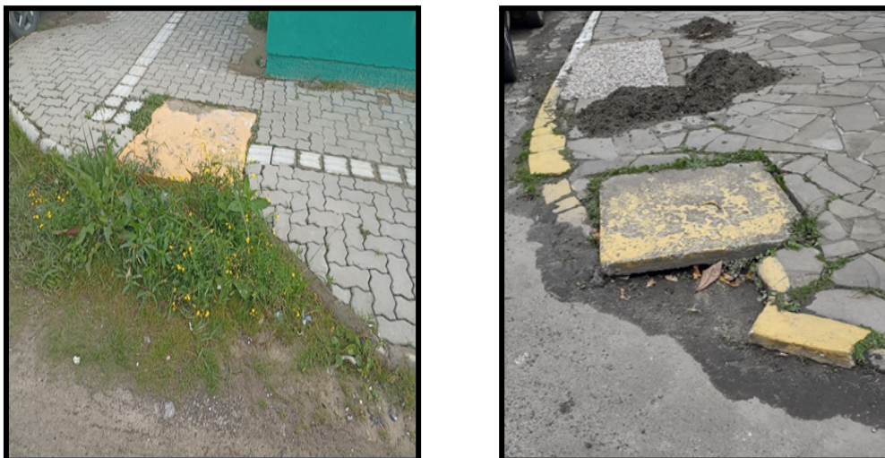
Foto 38 – Exemplos de bocas de lobo com manutenção e limpeza inadequadas
