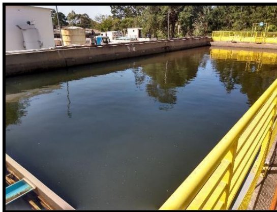
Foto 32.(d) - Decantadores convencionais
