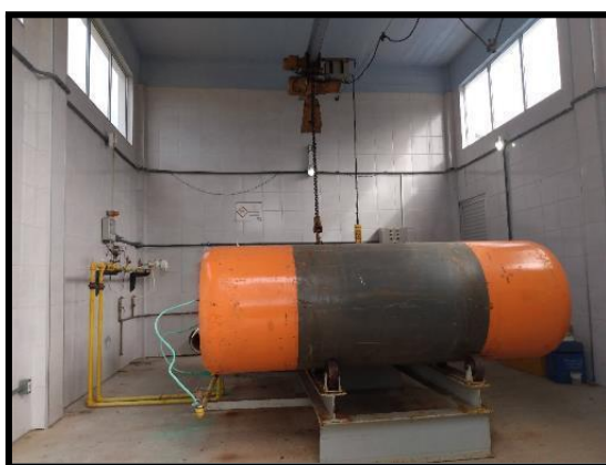
Foto 32.(g) - Tanques de armazenamento do cloro gás
