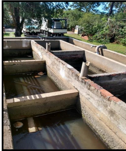
Foto 32.(c) - Floculadores hidráulicos
