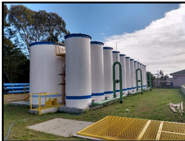
Foto 33.(a) - Imagem da ETA compacta
