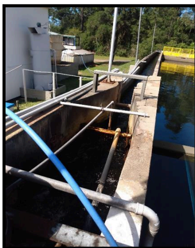
Foto 32.(b) - Canal para a dosagem e mistura do coagulante (Calha Parshall)
