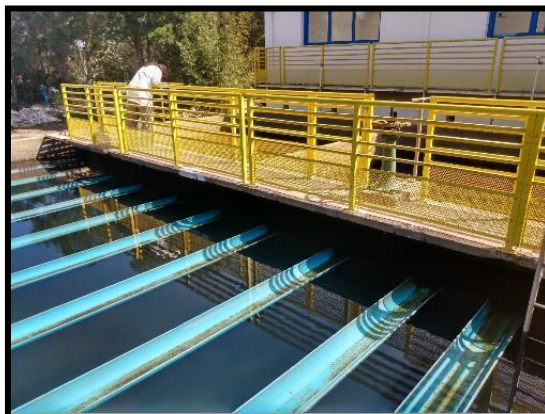
Foto 32.(e) - Calhas de coleta de água clarificada
