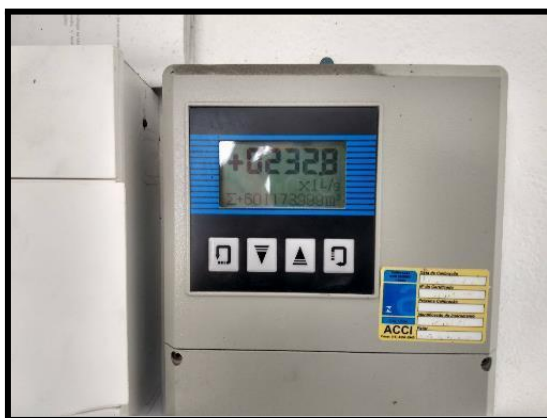
Foto 32.(h) - Medidor de vazão
