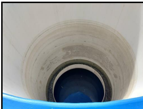
Foto 33.(c) - Sistema de filtração
